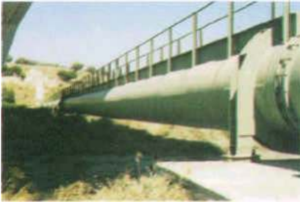
Fig. 10. Grande conduta de abastecimento de água
